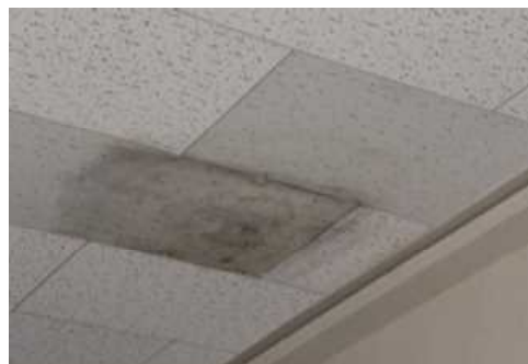
②校舎3 内部仕上(B評価) 代表写真:1階廊下の天井のシミ 所見:30年経過で、経年劣化。
