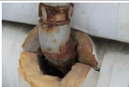
①校舎1 機械設備(B評価) 代表写真:瞬間湯沸器排水管の錆 所見:未更新部分が経年劣化。
