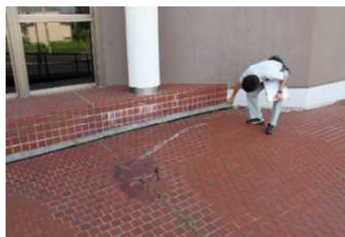
⑥外構 代表写真:ポーチの沈降による割れ 所見:沈降防止対策ののち個別補修が必要。
