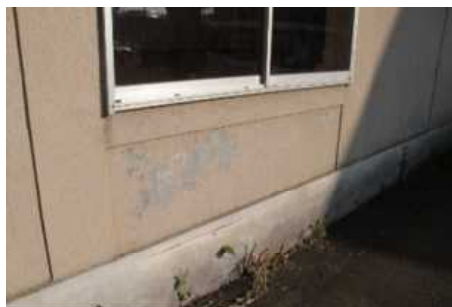
⑤屋内運動場 外壁(C評価) 代表写真:外壁塗膜の剥離 所見:広範囲に劣化。
