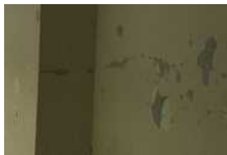
④校舎9 内部仕上(C評価) 代表写真:壁面塗装の剥離 所見:40年経過で、経年劣化。
