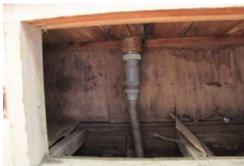
①校舎1 機械設備(D評価) 代表写真:排水配管 所見:50年経過で、経年劣化。
