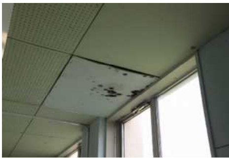
①校舎2～3 内部仕上(C評価) 代表写真:廊下天井のシミ 所見:42年経過で、経年劣化。
