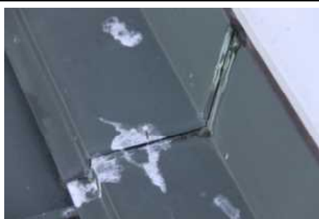
①校舎1 屋根・屋上(C評価) 代表写真:屋根と外壁取り合いの板金不具合 所見:板金の不具合による雨漏りが1箇所。
