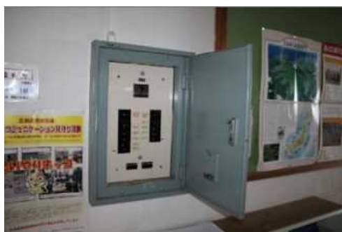
③校舎 電気設備(C評価) 代表写真:分電盤 所見:43年経過。
