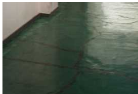
②校舎6～8 内部仕上(C評価) 代表写真:床スラブのひび割れ 所見:46年経過で、経年劣化。
