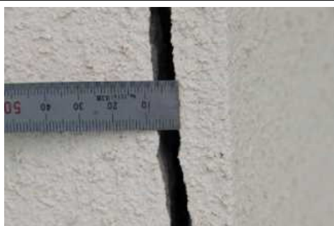
①校舎 外壁(C評価) 代表写真: 外壁モルタルの割れ 所見: 広範囲に劣化。
