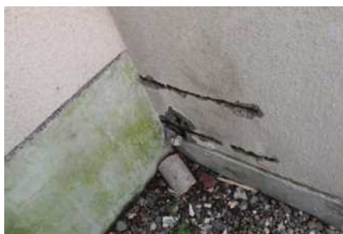
⑤屋内運動場 外壁(D評価) 代表写真:外壁鉄筋爆裂 所見:広範囲に劣化。
