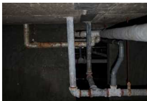
⑥屋内運動場 機械設備(D評価) 代表写真:排水配管の劣化 所見:43年経過で、経年劣化。
