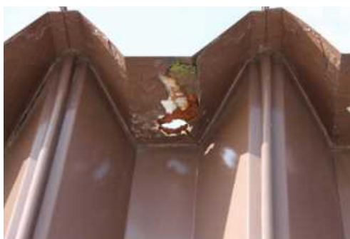
①屋根・屋上(B評価) 代表写真:屋根の穴あき 所見:部分的な劣化。
