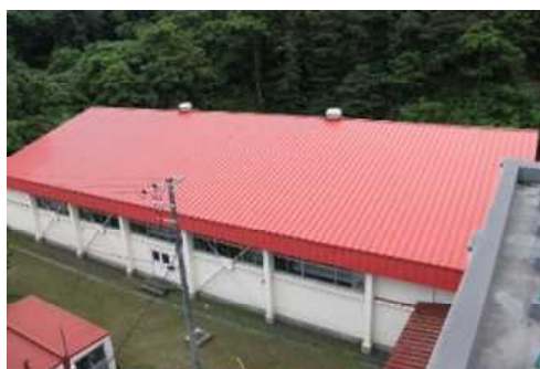
⑤屋内運動場 屋根・屋上(A評価) 代表写真:屋根 所見:良好。
