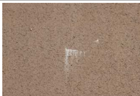
②外壁(A評価) 代表写真:外壁に部分的なエフロ有り 所見:個別補修が必要な箇所もあるが、全体的には良好。
