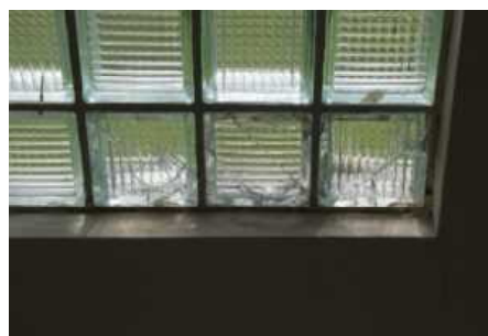
④校舎6～9 外壁(B評価) 代表写真:ガラスブロックの割れ 所見:部分的な劣化。
