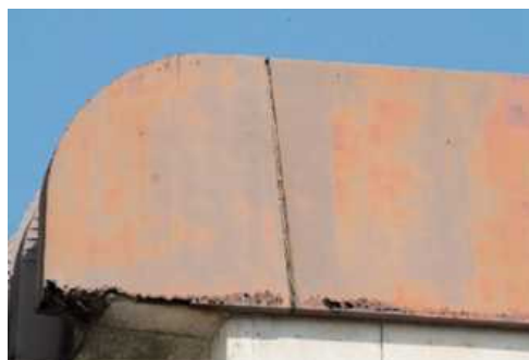
④屋内運動場 屋根・屋上(D評価) 代表写真:破風の錆、腐食 所見:広範囲に著しい劣化。
