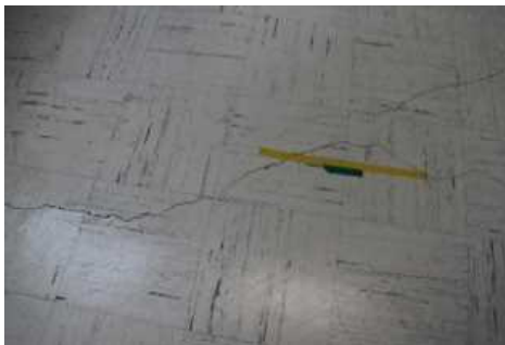
⑤校舎1 内部仕上(C評価) 代表写真:廊下床ビニールタイルの割れ 所見:42年経過で、経年劣化。
