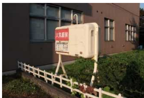
⑤機械設備(B評価) 代表写真:ホームタンクの錆出し 所見:36年経過で、経年劣化。
