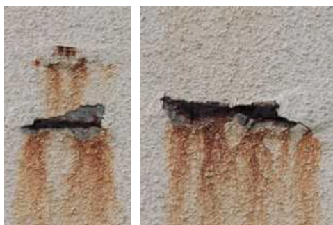
⑤屋内運動場 外壁(C評価) 代表写真: 外壁鉄筋爆裂 所見: 広範囲に劣化。鉄筋露出が4箇所程。
