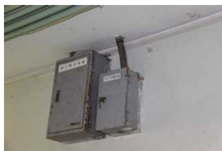
③校舎6～8 電気設備(D評価) 代表写真:動力盤筐体の錆 所見:46年経過で、経年劣化。
