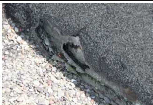
①校舎 屋根・屋上(C評価) 代表写真:屋上防水層の穴あき 所見:防水層周辺で劣化が進行。
