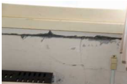
①校舎1～5 内部仕上(C評価) 代表写真:壁の欠損を伴う大きなひび割れ 所見:57年経過で、経年劣化。
