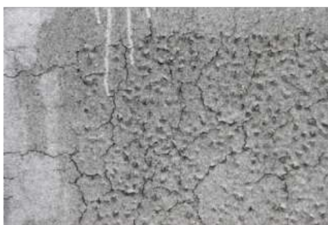
①校舎 屋根、屋上(D評価)
