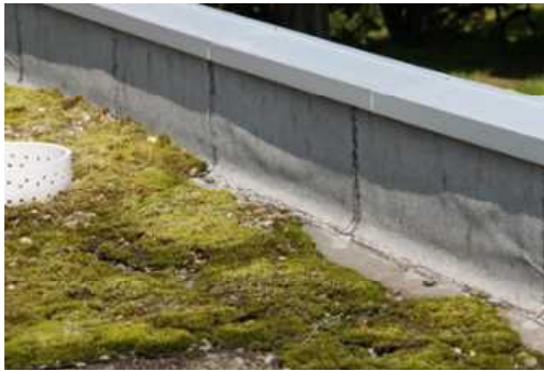
①屋根・屋上(C評価) 代表写真: 屋上立上りの防水層の膨れ 所見: 広範囲に劣化。
