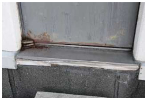
③校舎 外壁(D評価) 代表写真:外部鉄扉の腐食の進行 所見:広範囲に劣化。
