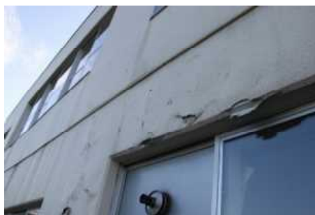
③校舎2 外壁(C評価) 代表写真:外壁塗膜の剥離 所見:広範囲に劣化。
