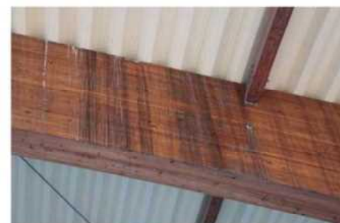
④内部仕上(B評価) 代表写真:プール表し梁の汚れ 所見:15年経過だが、プール周りは劣化が進行。
