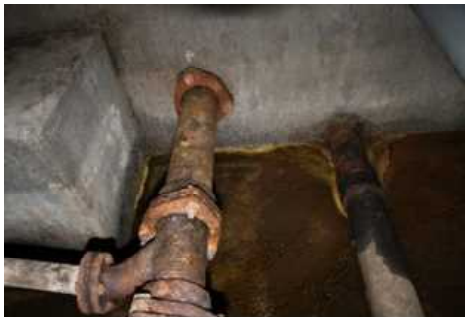
③校舎2～3 機械設備(D評価) 代表写真:排水配管の腐食 所見:42年経過で、経年劣化。
