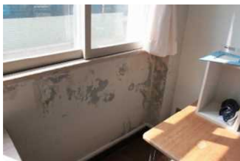
③校舎 内部仕上(C評価) 代表写真: 教室壁の塗膜剥離 所見: 50年経過で、経年劣化。
