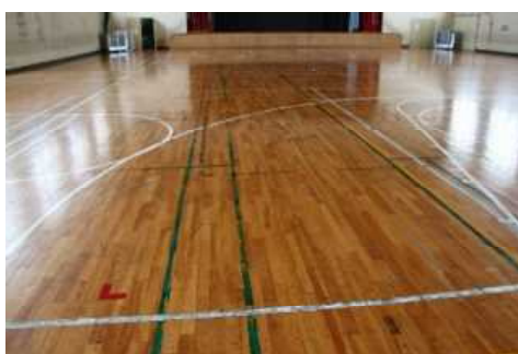
⑥屋内運動場 内部仕上(B評価) 代表写真: アリーナ床ラインの摩耗 所見: 33年経過で、経年劣化。
