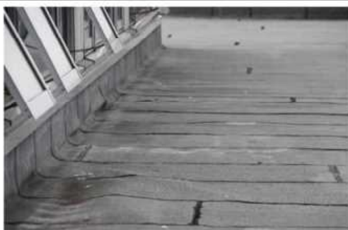
①屋根・屋上(D評価) 代表写真:屋上防水層内への水の進入 所見:広範囲に劣化。雨漏りが複数。
