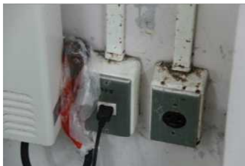
③校舎3 電気設備(B評価) 代表写真:電気配線モールの錆出し 所見:30年経過で、経年劣化。
