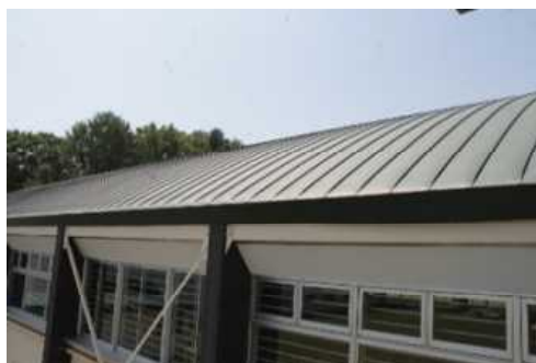
⑤屋内運動場 屋根・屋上(A評価) 代表写真:屋根 所見:良好。
