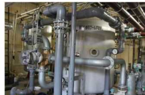
⑥機械設備(A評価) 代表写真:ろ過器 所見:プール設備は計画的に修繕を実施。
