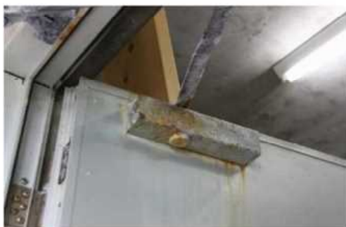
⑤内部仕上(B評価) 代表写真:プール周りのドアの錆 所見:15年経過だが、プール周りは劣化が進行。
