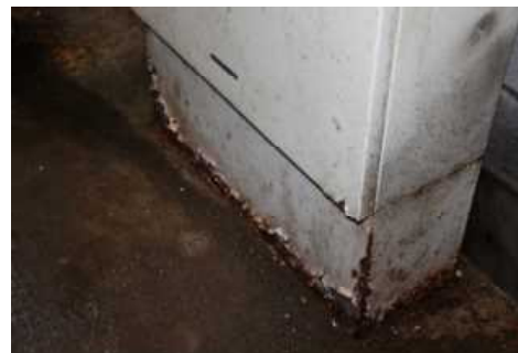
②校舎2～3 電気設備(C評価) 代表写真:制御盤地際の腐食 所見:42年経過で、経年劣化。
