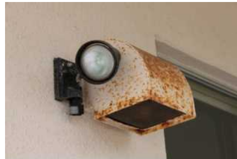
④校舎1 機械設備(D評価) 代表写真:理科室外部フードの錆 所見:42年経過で、経年劣化。
