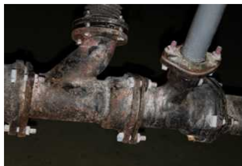
④校舎 機械設備(D評価) 代表写真:排水配管の劣化 所見:43年経過で、経年劣化。
