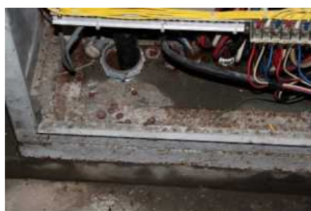
⑤校舎4～8 電気設備(C評価) 代表写真: 動力盤底面 所見: 41年経過で、結露水による錆がある。
