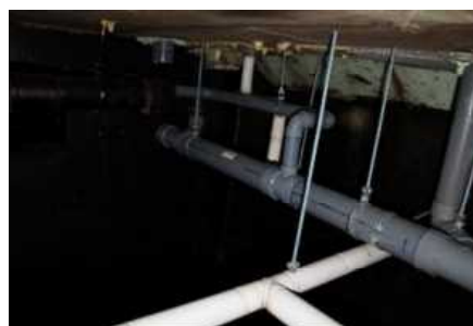
⑥屋内運動場 機械設備(B評価) 代表写真: 排水配管 所見: 20年経過。
