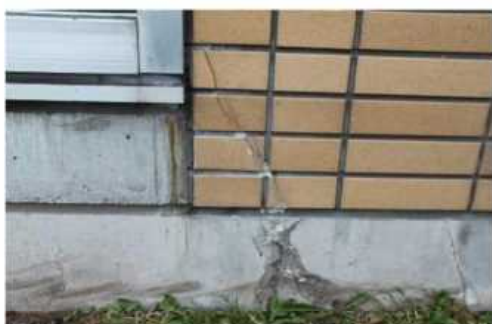
③外壁(B評価) 代表写真:外壁タイルの割れ 所見:部分的な劣化。
