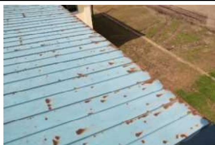
①校舎1～3 屋根・屋上(C評価) 代表写真: 屋根の錆 所見: 広範囲に劣化。
