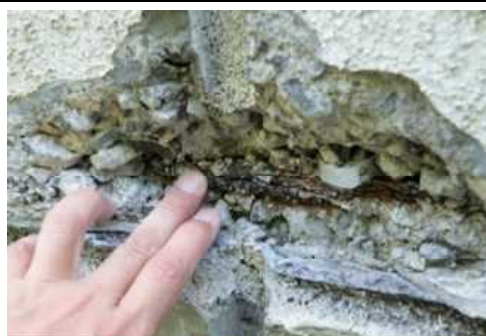
②校舎 外壁(D評価) 代表写真:外壁北面の躯体劣化 所見:広範囲に著しい劣化。
