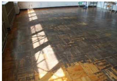
④校舎4 内部仕上(C評価) 代表写真:教室床の汚損及び塗装剥離 所見:43年経過で、経年劣化。
