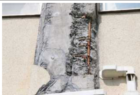
②校舎 外壁(C評価) 代表写真: 外壁鉄筋露出 所見: 広範囲に劣化。
