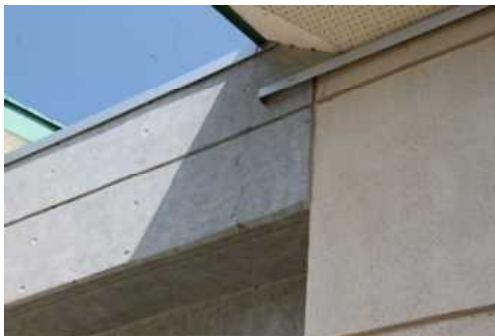
③外壁(B評価) 代表写真: 躯体の軽微なひび割れ 所見: 部分的な劣化。
