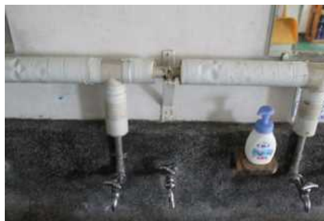
④校舎 機械設備(C評価) 代表写真: 水飲み場給水管保温巻きの剥がれ 所見: 50年経過で、経年劣化。
