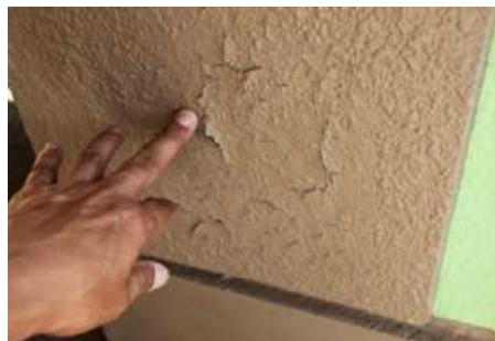
④校舎2 外壁(C評価) 代表写真:外壁塗膜の膨れ(内部に漏水) 所見:広範囲に劣化。
