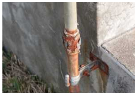
⑥屋内運動場 機械設備(B評価) 代表写真:排水管の錆 所見:各部材ごとに改修されているため、劣化は部分的。
