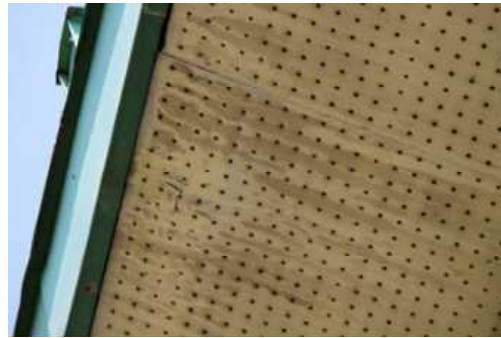
②屋根・屋上(C評価) 代表写真: 軒天の汚損 所見: 広範囲に劣化。
