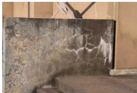
⑥屋内運動場 外壁(C評価) 代表写真:ポーチ袖壁のひび割れ 所見:広範囲に劣化。
