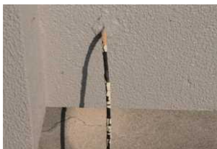
③校舎4～5 機械設備(B評価) 代表写真:油配管被覆の剥がれ 所見:各部材ごとに改修されているため、劣化は部分的。
