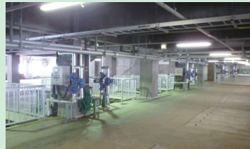
② センター内部の様子(最終沈殿池)
